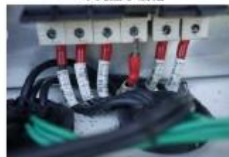
Inverter 01 E1-1-3-1-(40) 串列端子氧化
