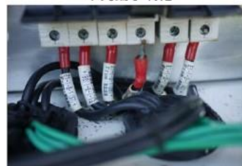
Inverter 01 E1-1-3-1-(40) 串列端子氧化
