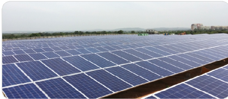
3.72MW 地面型 Hyderabad, 印度
