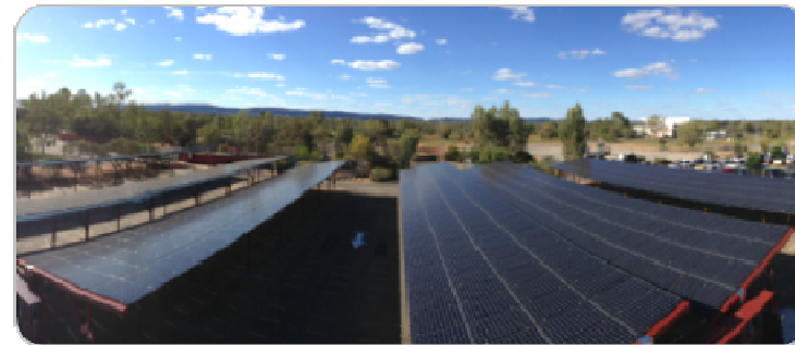
325kW 車棚屋頂, 愛麗斯泉機場, 澳洲
