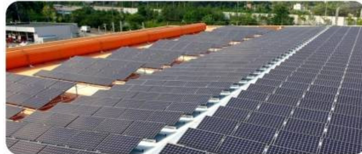
1.7MW 屋頂型 釜山, 韓國
